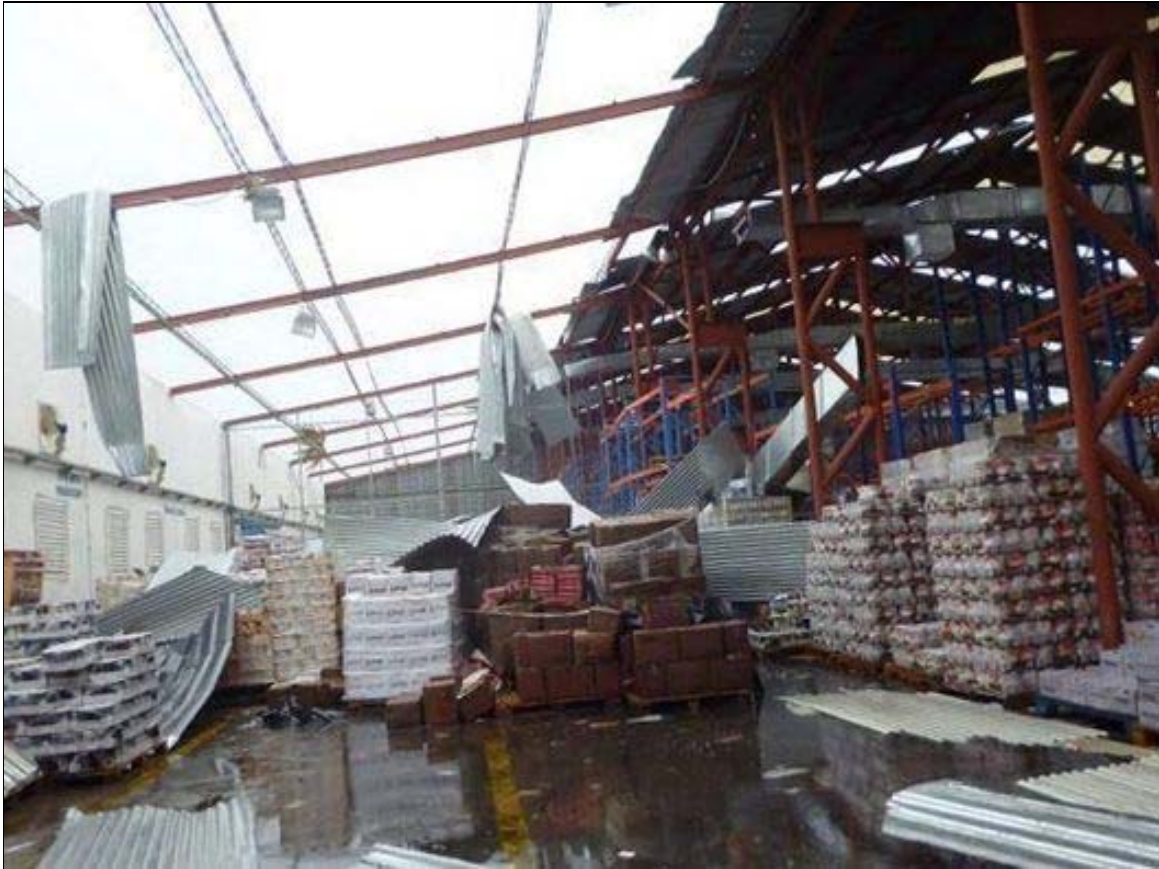
Dommages importants à un entrepôt de produits et denrées pour l'industrie touristique dans la province de Villa Clara
