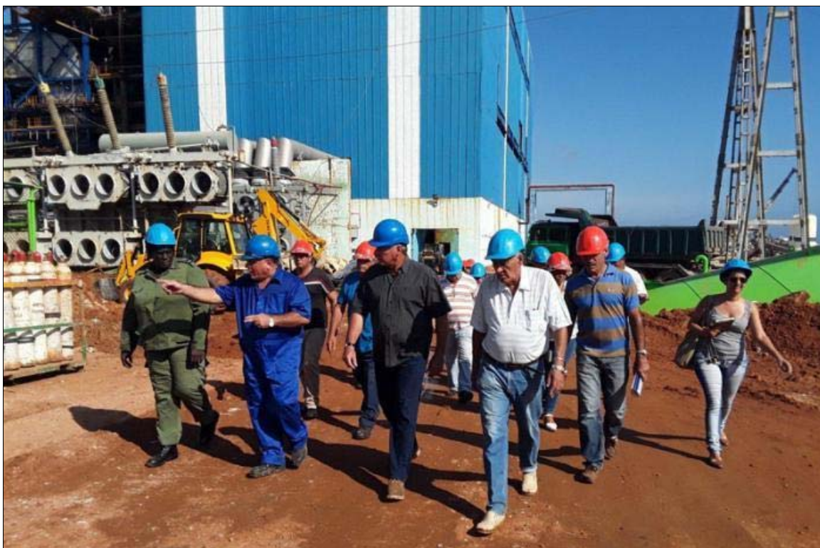
Le premier vice-président du Conseil d'État et du Conseil des ministres Miguel Díaz-Canel Bermúdez (au centre) inspecte les opérations de rétablissement à l'usine thermoélectrique très endommagée de Matanzas le 13 septembre 2017.
