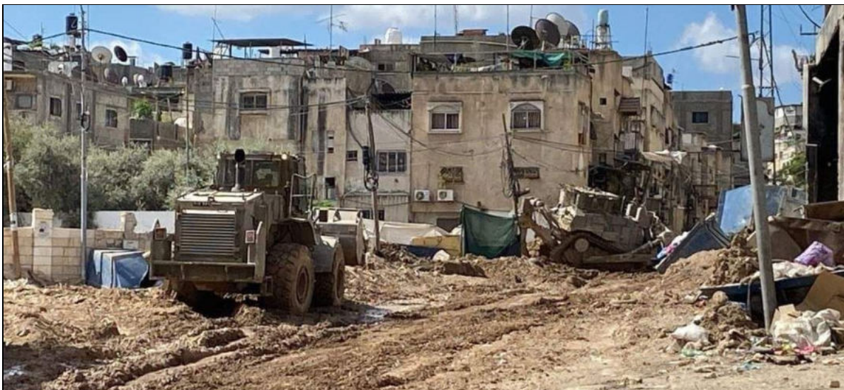
Des bulldozers détruisent des infrastructures à Tulkarem, 3 septembre 2024
