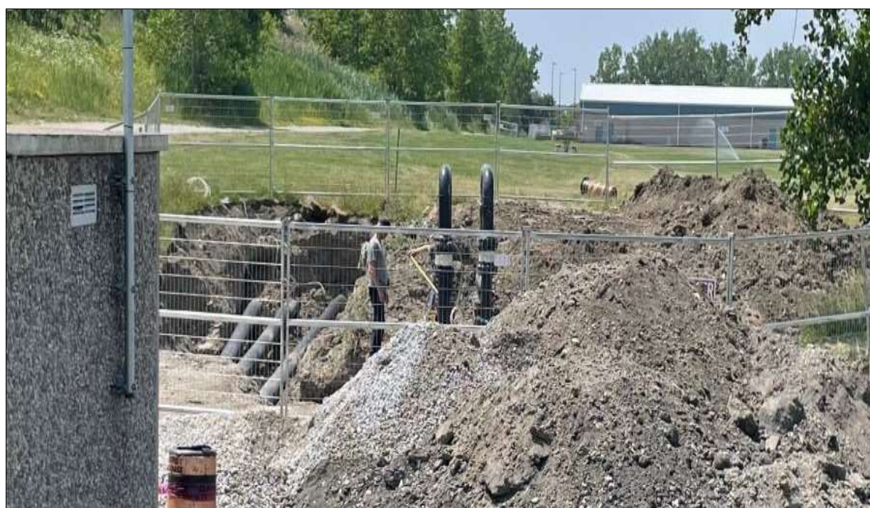
Travaux à Malden Park, Windsor, Ontario, pour l'extension du réseau de pipelines et de puits de saumure pour l'extraction et le transport de la saumure de sel vers l'usine d'évaporation de Sel Windsor
