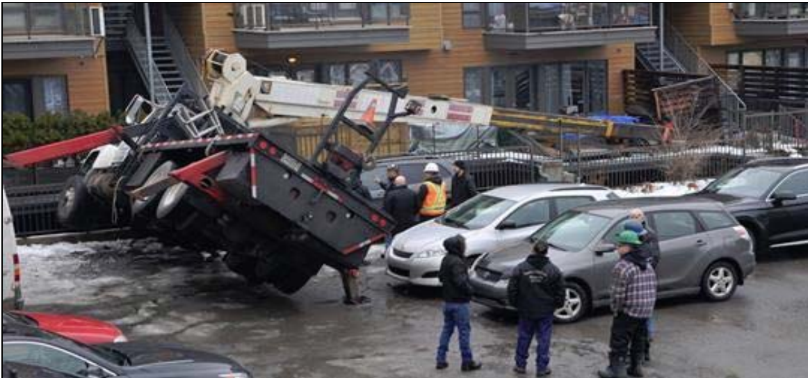
Une grue renversée, novembre 2018
